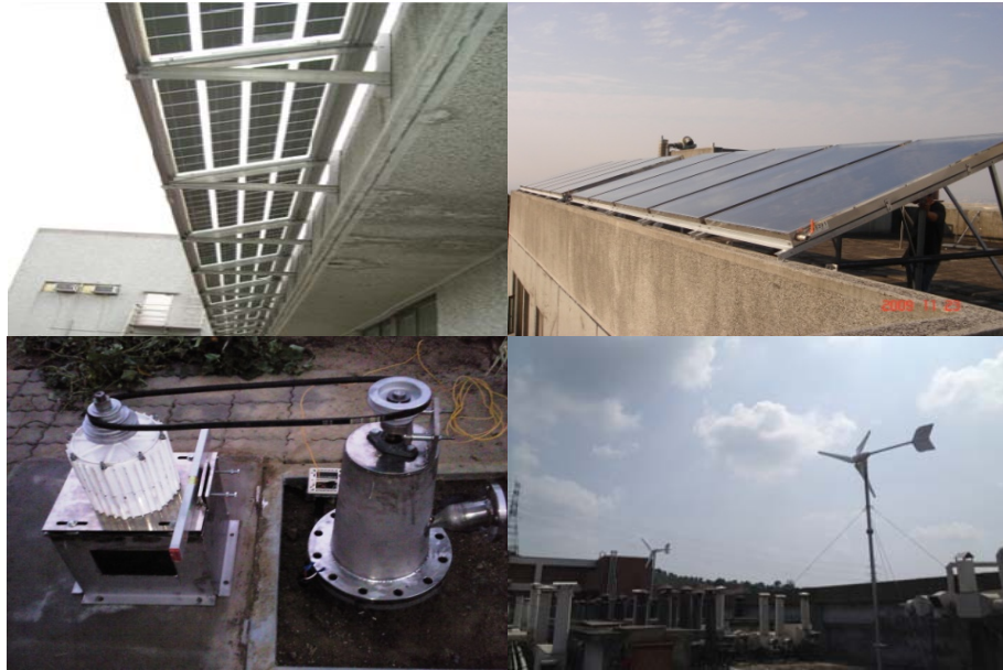
再生能源設置情形
