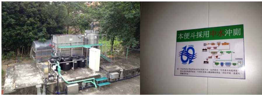
中水回收設施處理及設施實景
